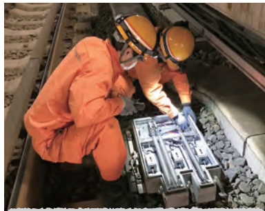
主に駅に付帯する電灯設備、ネットワーク設備のメンテナンスを担当しています。
